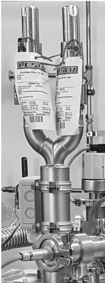
Abbildung 27: Installierte LESER-Sicherheitsventile am Kryostaten
