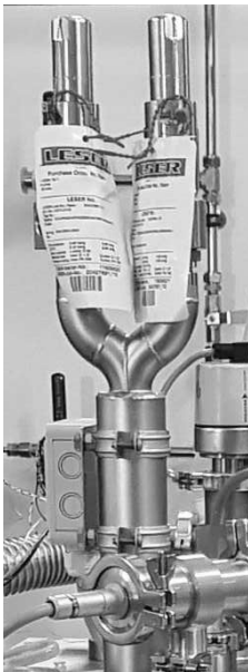
Abbildung 9: Installierte LESER-Sicherheitsventile am Kryostaten
